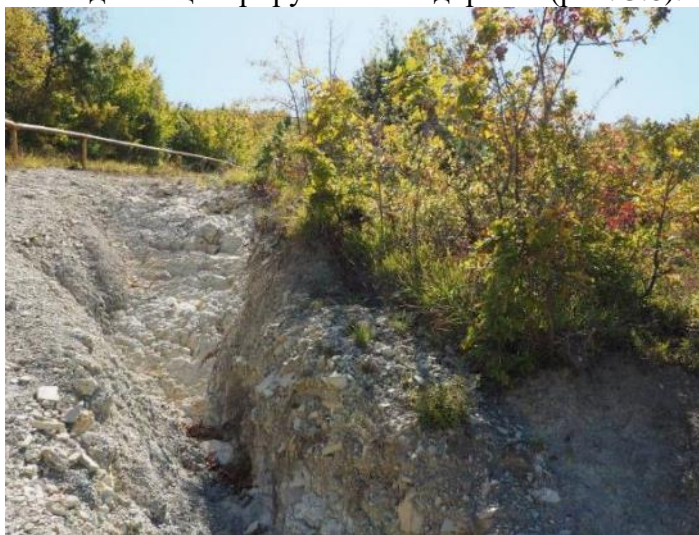
Рисунок 3.8 - Глубокая промоина на дороге вдоль трассы газопровода
